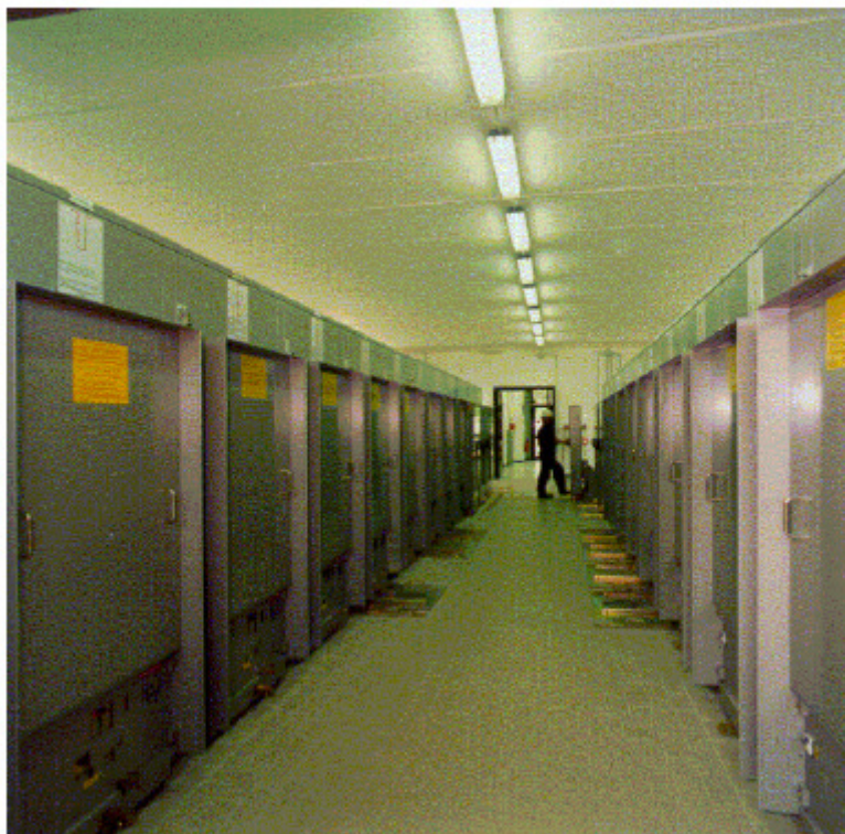
Esempio di cabina protetta
